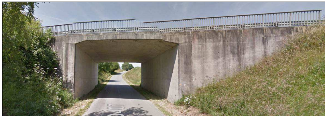
Figure 13 : Vue du PI de la RD407 côté élargissement au Sud (source Google Street View)
